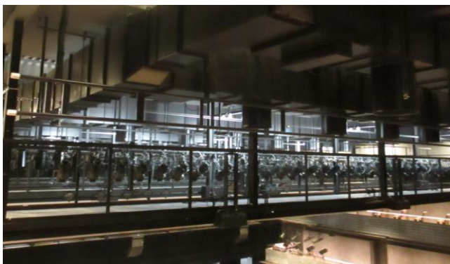
舞台頭上の音響設備
